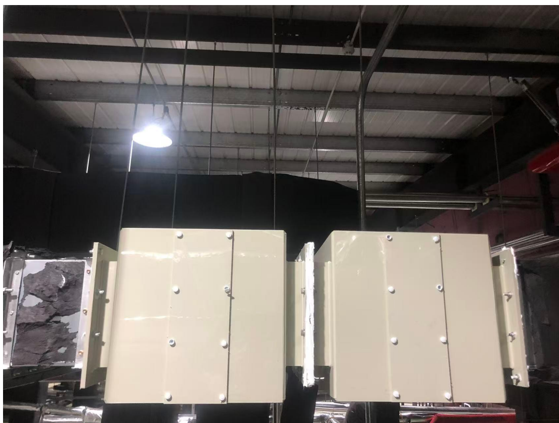
图 3-3 项目废气处理设施
